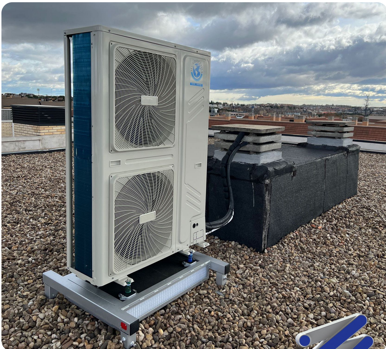
BANCADA AIR / ACÚSTICA
